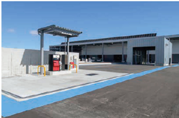
自動給油設備
